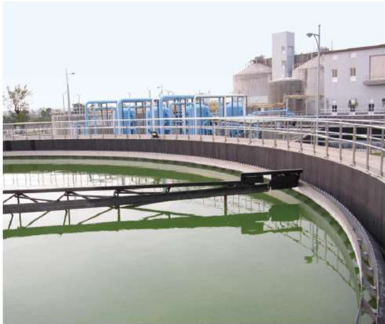
▲ 高雄市 楠梓區 汙水處理廠
